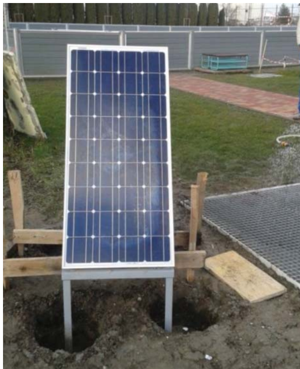
Obr. 31: Fotovoltaický panel sezónne zásobuje vodné čerpadlo dostatočným výkonom a v zime sa využije pre osvetlenie areálu ZŠ v Topoľníkoch
