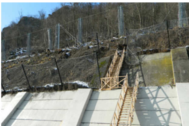
Obr. 9.13 Strmé svahy jsou zabezpečeny proti padajícím kamenům záchytným plotem nebo drátěným pletivem. Tato opatření mohou být nezbytná pro stabilizaci svahů, zároveň však zvyšují bariérový účinek a vedou ke ztrátě přírodních stanovišť na okrajích silnice. Je-li to možné, měla by být upřednostňována citlivější řešení. Rychlostní silnice R2, Zvolen, Slovensko. © Miroslav Jarný
