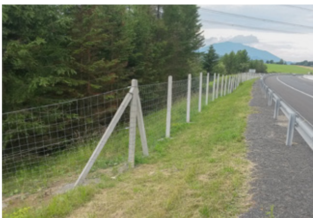
Obr. 6.19 Oplocení zabraňuje vstupu zvířat na silnici a tím zvyšuje bezpečnost provozu, významně však zvyšuje bariérový účinek dopravní infrastruktury. Měly by být proto instalovány pouze tam, kde mají zvířata možnost k přechodu infrastruktury využívat bezpečný průchod pro faunu. © archiv NDS
