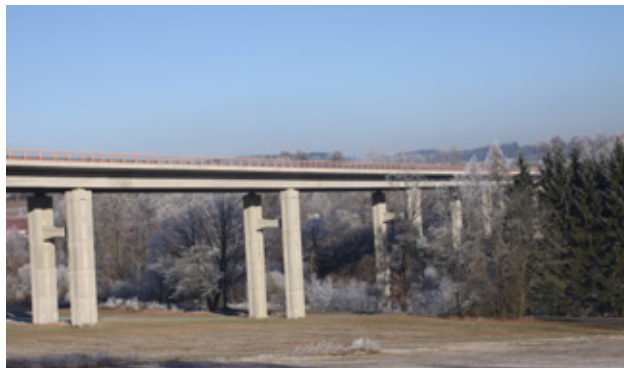
Obr. 10.34 Viadukty přes celá údolí umožňují průchod většině druhů živočichů, včetně velkých savců. V případě odpovídajících podmínek mohou propojovat celé ekosystémy. Česká republika. © Václav Hlaváč
