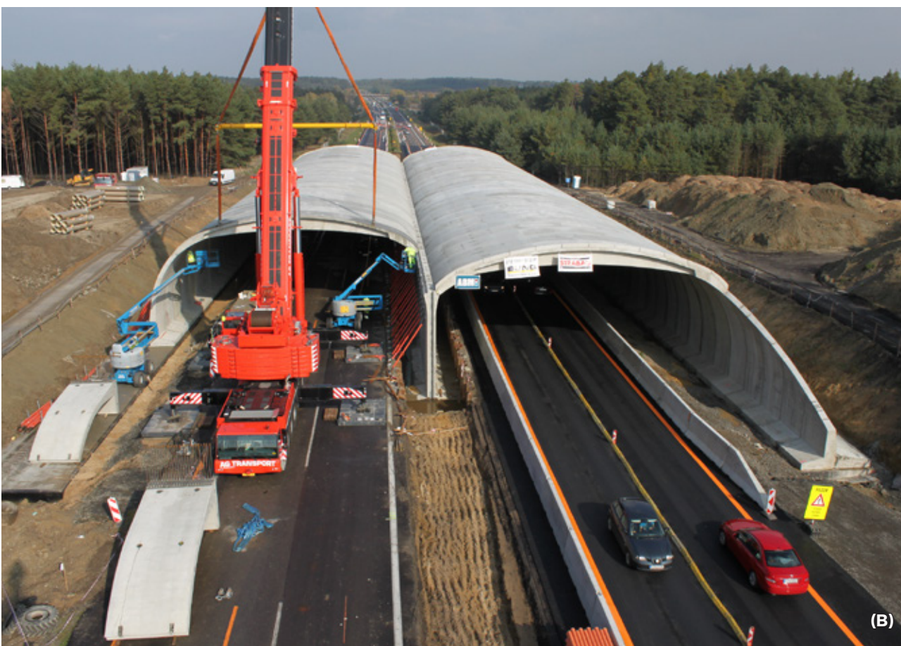
Obr. 9.16 A) Výstavba raženého tunelu ve Víšňové na dálnici D1, Slovensko. B) Výstavba hloubeného tunelu – zelený most poblíž Moravského Svätého Jánu, Slovensko. © archiv NDS
