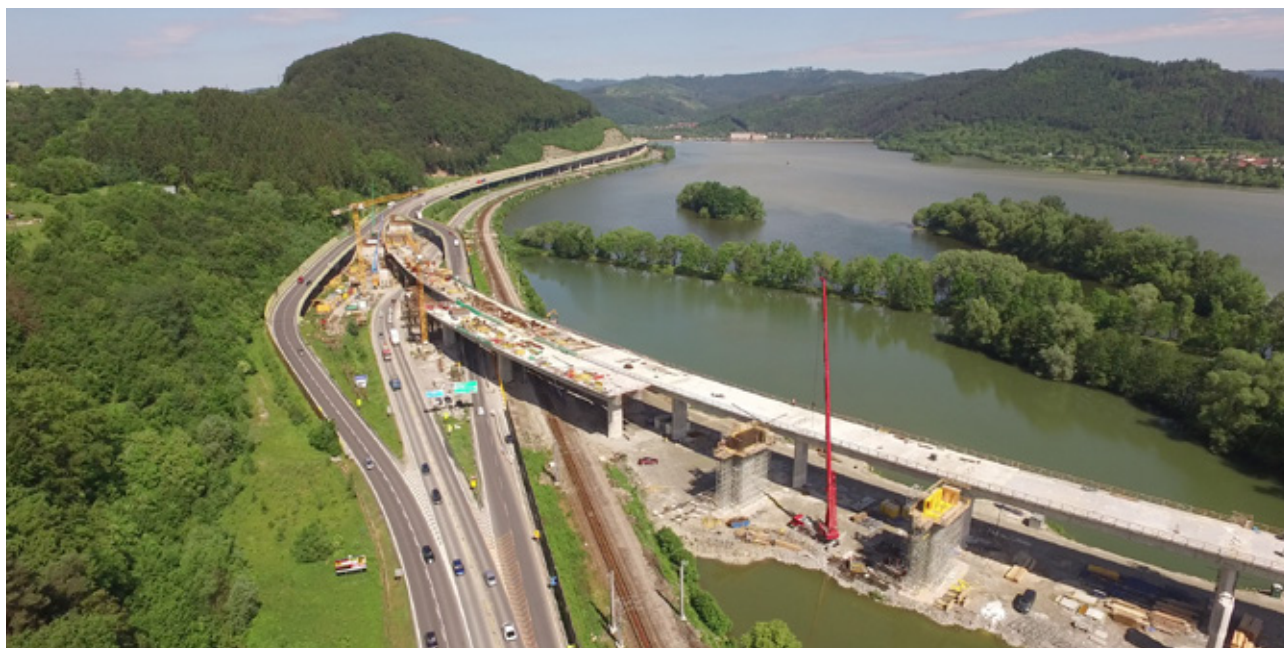
Obr. 8.10 Výstavba dálnice paralelně se silnicí nižší třídy, železnici nebo říčním kanálem vytváří vícenásobný bariérový účinek. © archiv NDS
