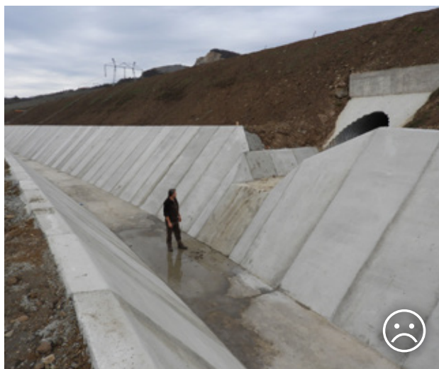
Obr. 9.19 Masivní betonový žlab pro odvedení srážkové vody z dálnice má velmi rušivý účinek na krajinu, zvyšuje bariérový účinek a neumožňuje použití propustku jako průchodu pro faunu. Takové řešení rovněž představuje past pro menší živočichy, kteří nemají šanci se dostat z betonového kanálu ven. © Ivo Dostál
