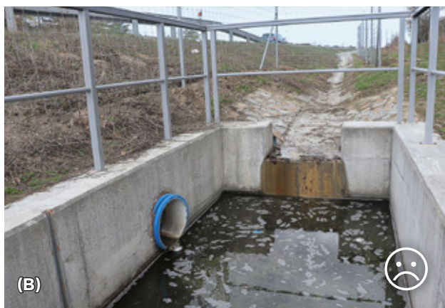
Obr. 9.17 Malá retenční nádrž se při poklesu hladiny stává pastí pro mnoho drobných živočichů. Bylo by vhodné projektovat takové nádrže co nejpřirozenějším způsobem nebo alespoň s jednou šikmou stěnou, která umožní živočichům dostat se ven. Dálnice D1, Česká republika. © Petr Anděl (A), Václav Hlaváč (B)
