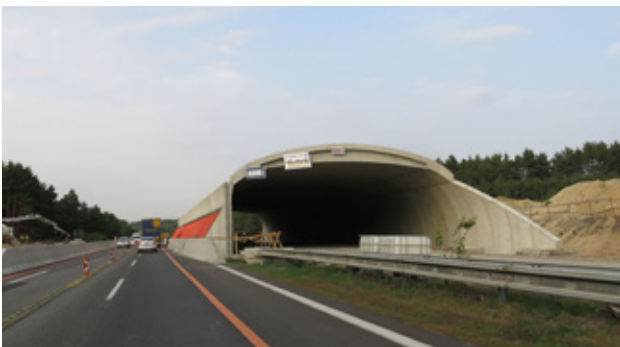
Obr. 8.11 Zelený most poblíž Moravského Svätého Jánu (Slovensko) byl vybudován za provozu stávající dálnice D2. V původní podobě byl dlouhý úsek dálnice zcela neprůchodný. Dálnice v tomto místě kříží Alpsko-karpatský migrační koridor. © Václav Hlaváč
