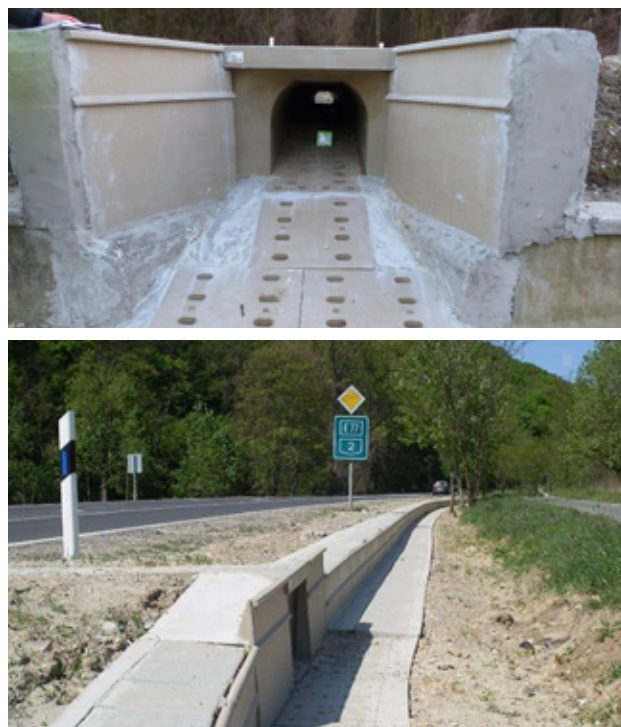
Obr. 10.48 Tunel pro obojživelníky je dobrým řešením pro překonání úzkých komunikací nižší třídy. Pro správnou funkčnost takového podchodu je nezbytnou podmínkou vybudování naváděcích bariér. © Andrés Weiperth
